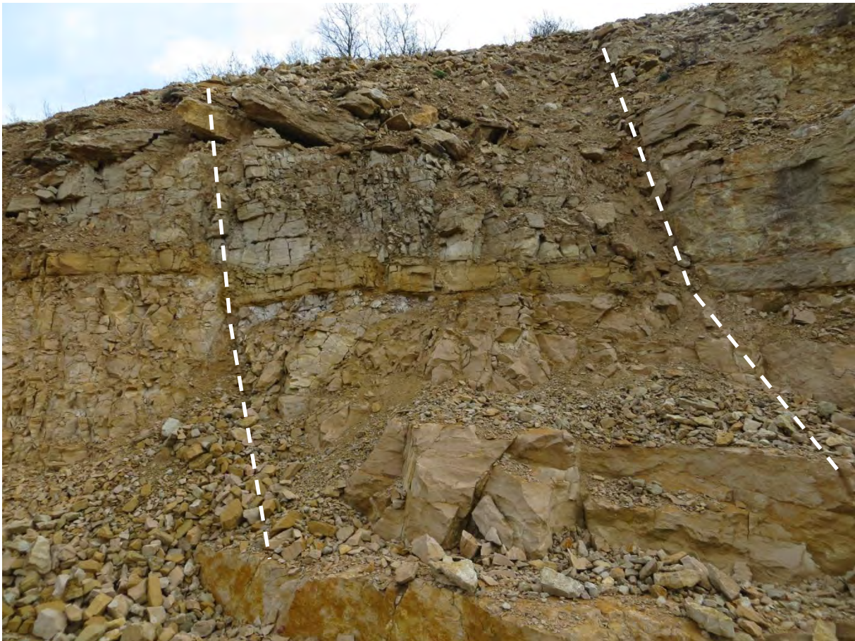
Exemple de zone disloquée susceptible de s'effondrer si le "verrou" en pied de talus est supprimé.
