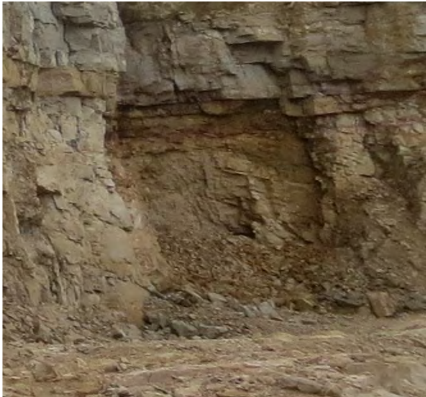
Exemple de sous cavage mettant en équilibre les éléments sus-jacent.
