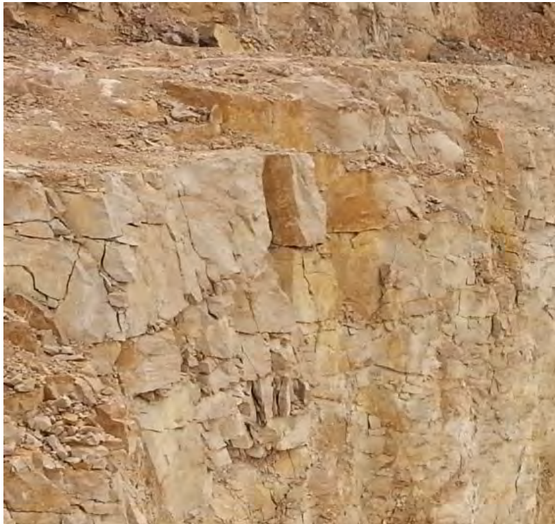
Exemple de bloc susceptible de se décrocher de la paroi.
